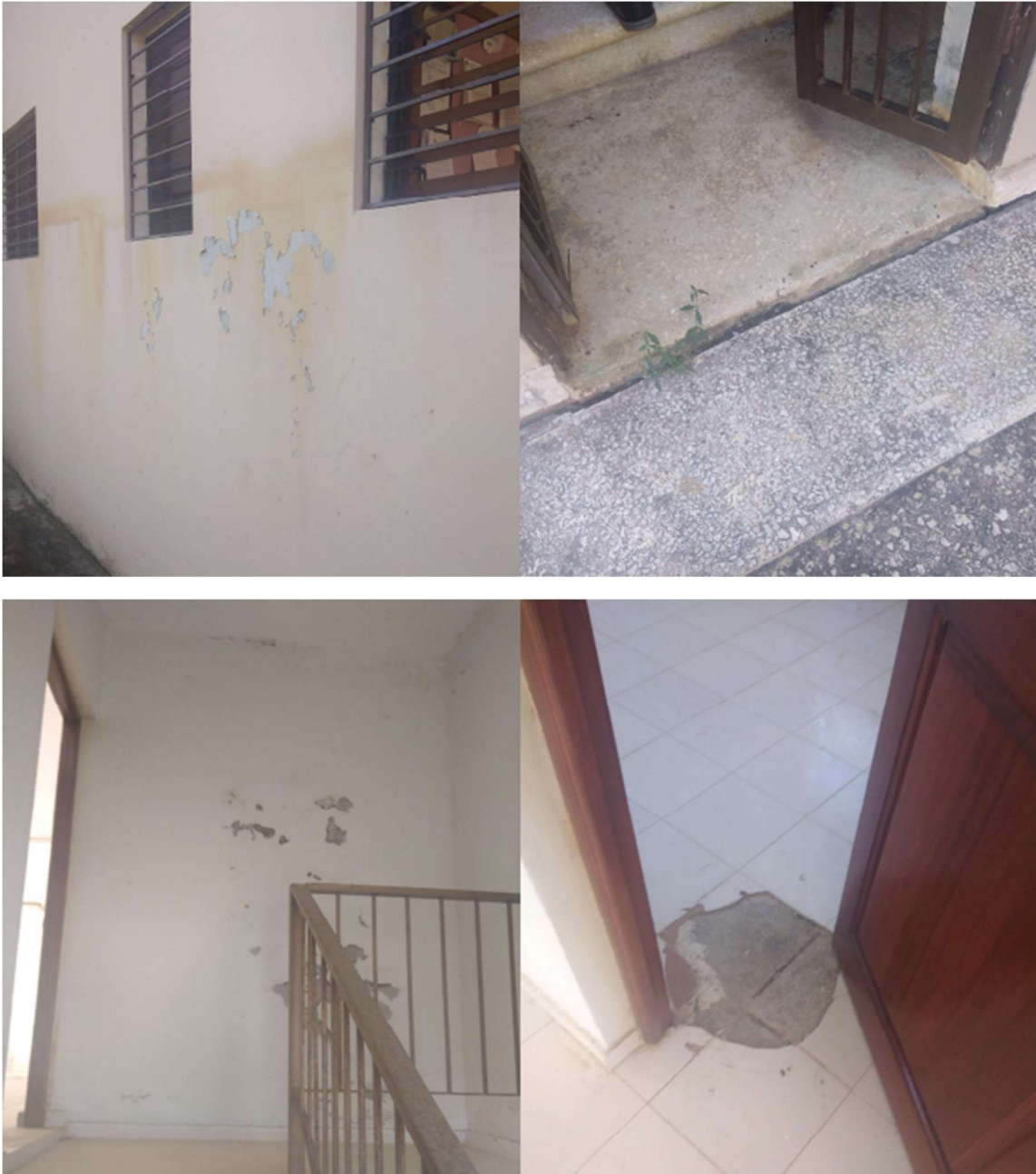
Ilustración 4. Filtraciones juzgado de paz Sabana de la Mar
