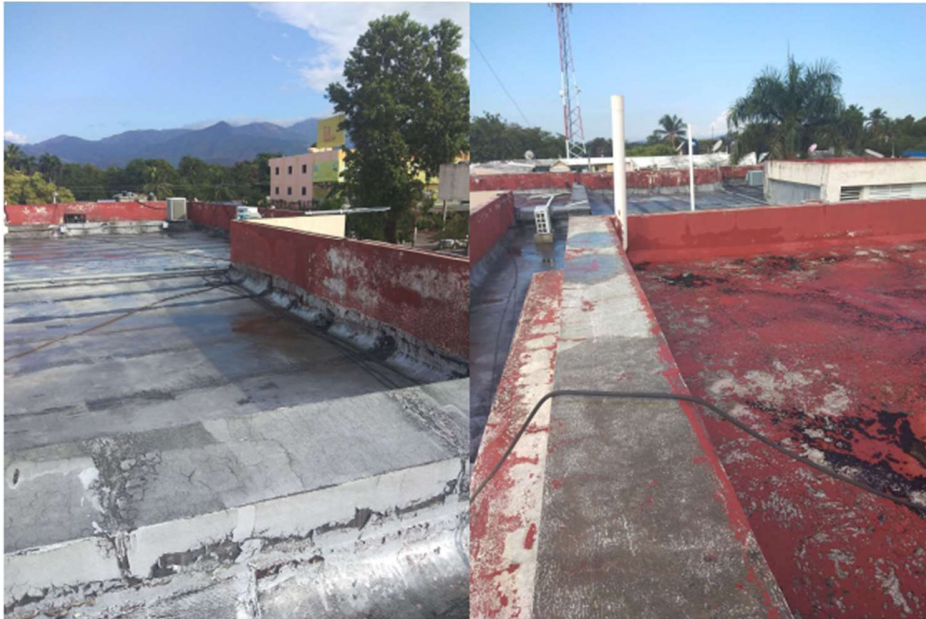
Ilustración 9. Techo de azua lona asfáltica deteriorada
