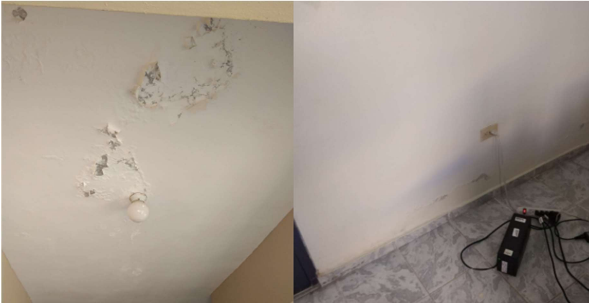
Ilustración 1. Filtraciones en techo
