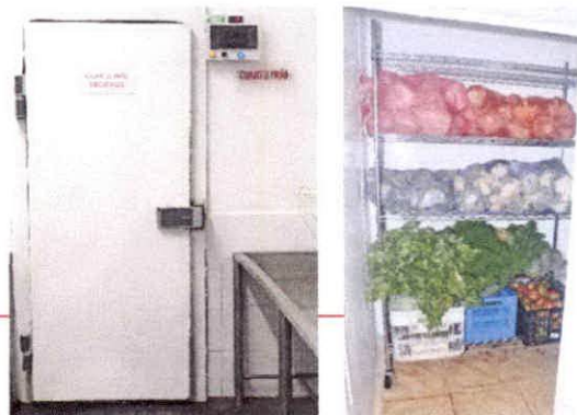
CUARTO FRÍO VEGETALES
