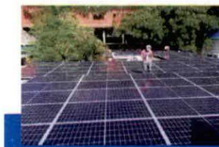
ENERGÍA QUISQUEYA Instalación paneles solares 32kWp
