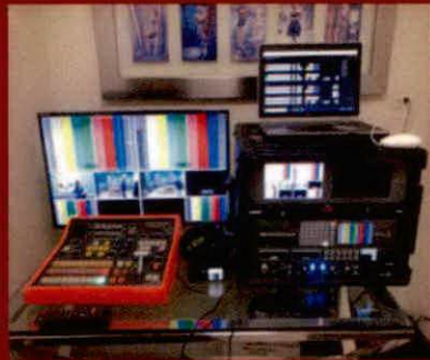
Switcher para Circuito Cerrado
